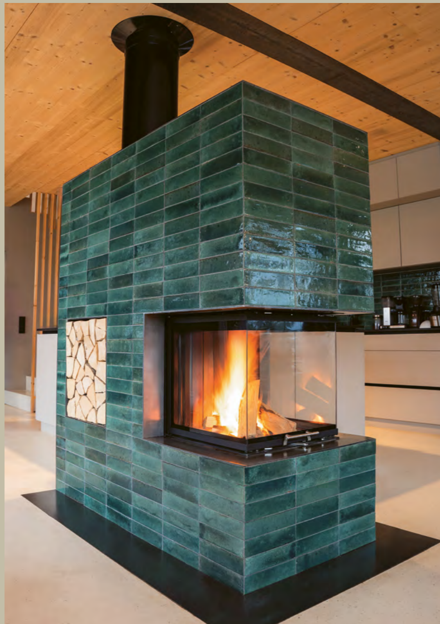
Heizkamin mit 3-seitigem Sichtfenster und Riemchenverkleidung
